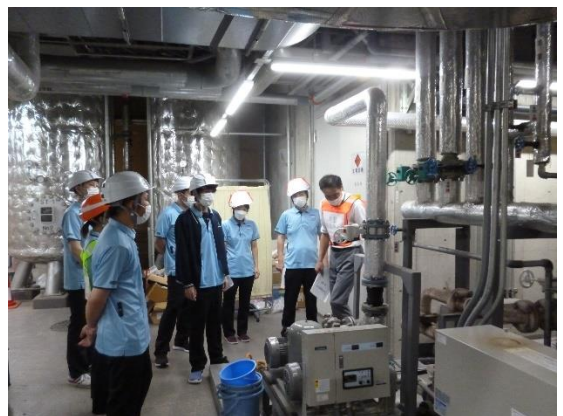
給水タンクの操作方法確認
