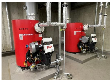
①本館ボイラー設備
