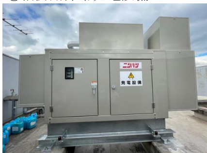
②消防用非常発電設備
