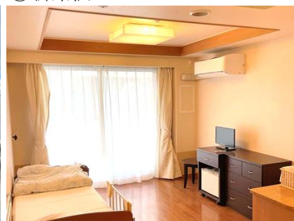
③新館個室エアコン
